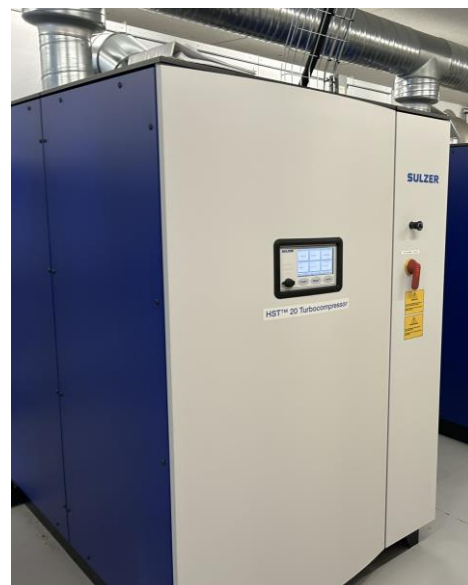
Figur 4.18: Turbokompressor til iltning af procestankene ved Sønderborg Renseanlæg.
