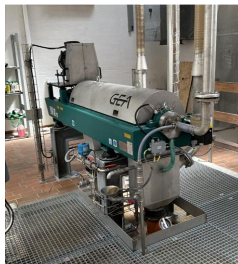
Figur 4.19: Dekanter til slamafvanding på Himmark Renseanlæg.
